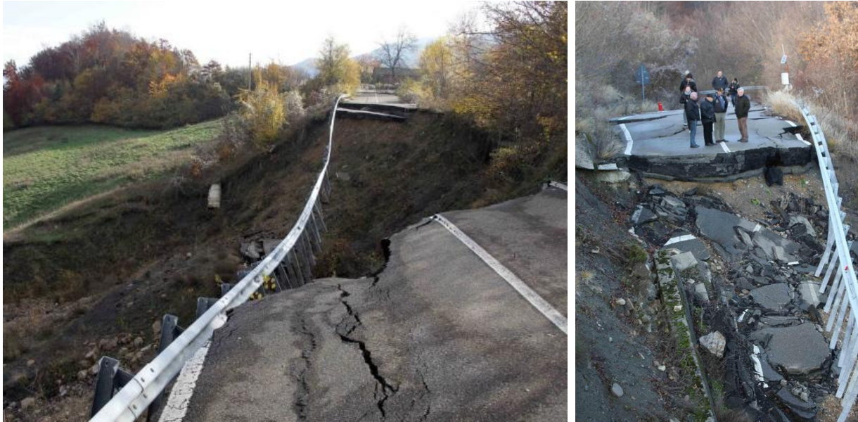
Figura 4.3: Danni alla SS63 causati dal fenomeno di dissesto di scivolamento in terra del 2008.
