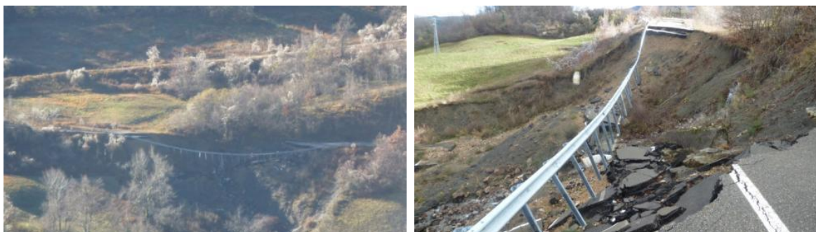
Figura 4.2: Dettagli dell'interruzione della strada nazionale nel settore G3 (Novembre 2010).
