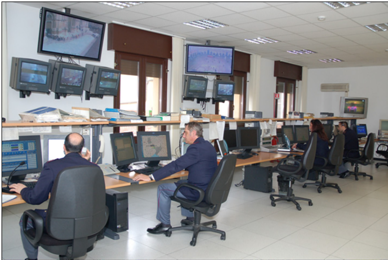
Fig.4 – Centrale di controllo
